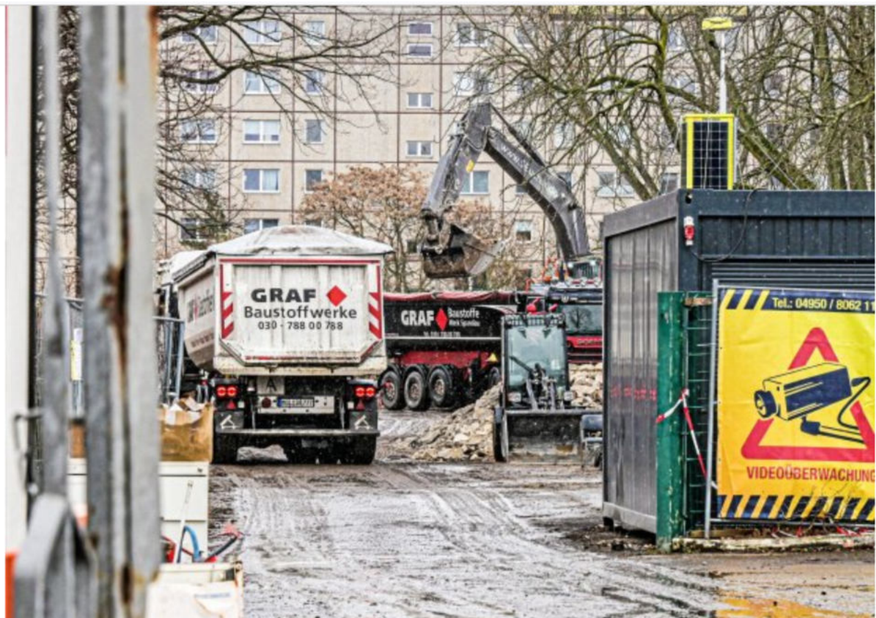
Auf dem Gelände des Krankenhauses Prenzlauer Berg beräumen Bagger die Fläche für eine neue Unterkunft für Geflüchtete mit drei Einzelgebäuden.
